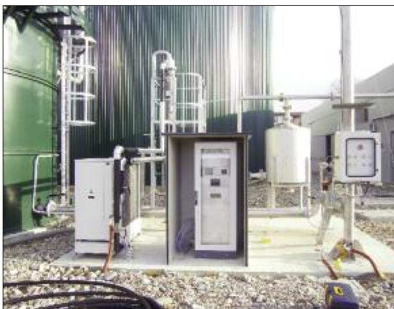
Sistema di analisi multipunto nell'impianto di cogenerazione di Spoleto
